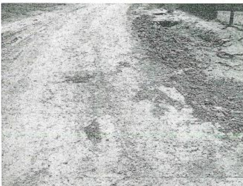
Bezeréd, Petőfi u. út és árok károsodások vis-maior szakvéleménye (EBR 322 920)
