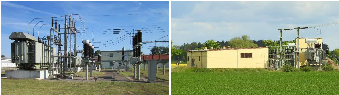
IV-5. ábra: Transzformátor, transzformátorház
